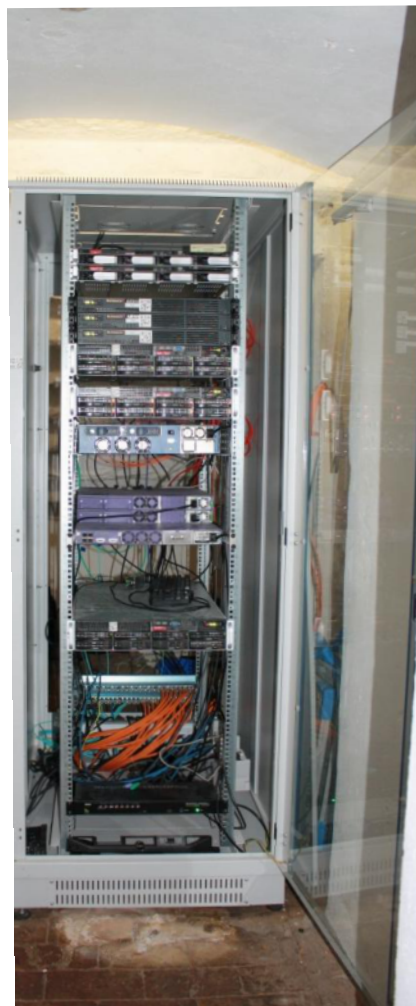
Im Herz des Future Internet Lab der Hochschule Anhalt: Server-Technik.
